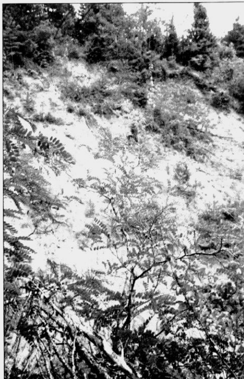
L'effondrement de l'ancienne route nationale au ravin Saint-Michel (vue prise selon un axe Sud/Nord). Au sommet de la photo se voient les restes du mur Nord de soutènement (cliché : J.C. Michel)
