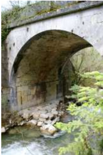
Les radiers sont détruits
