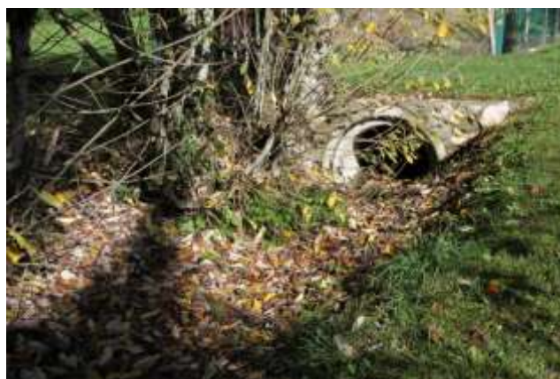
Canal d'amenée vers le bassin de rétention
