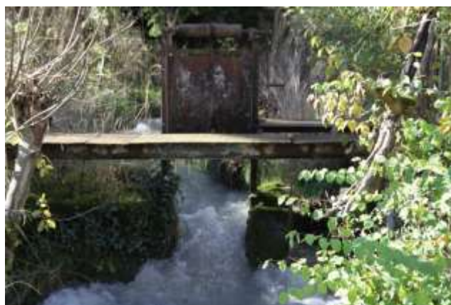
Vanne de dérivation sur le ruisseau de l'Hôpital
