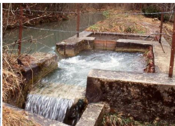
Fosse de répartition
